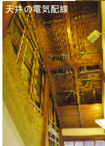
天井の電気配線
